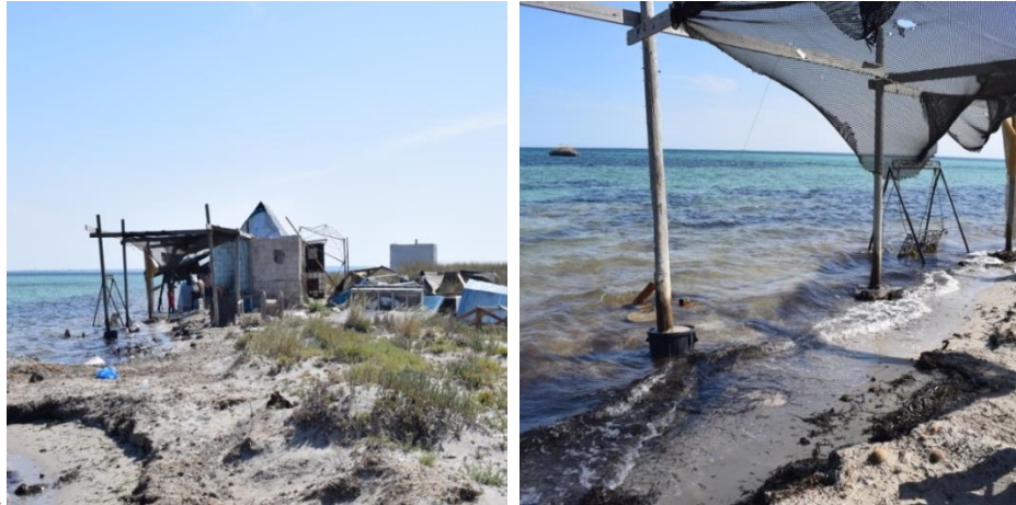
Figure 41. Dégâts de l'érosion à la base touristique « Yasmine »
